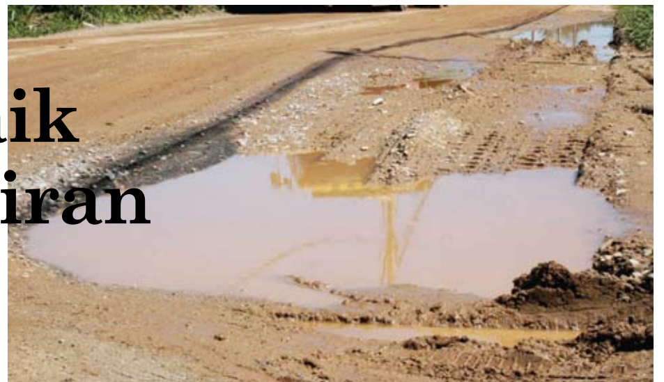
Kenderaan berat seperti lori menyebabkan jalan raya kembali rosak walaupun dibaiki berulang kali
