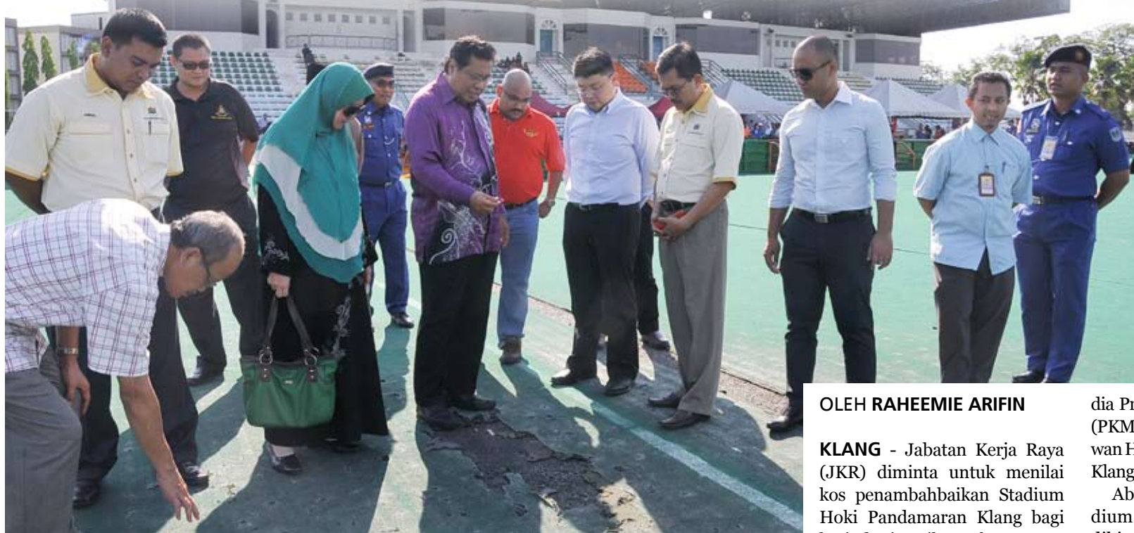
Menteri Besar, bersama pimpinan Kerajaan Negeri dan pihak MPK turun padang meninjau keadaan karpet di Stadium Hoki Pandamaran yang rosak
