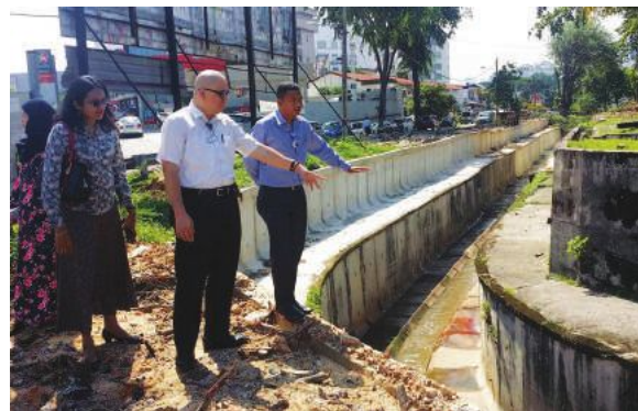
▲刘永山 (右2) 和官员视察灵市百乐花园20/1路旁的防洪沟施工情况。
