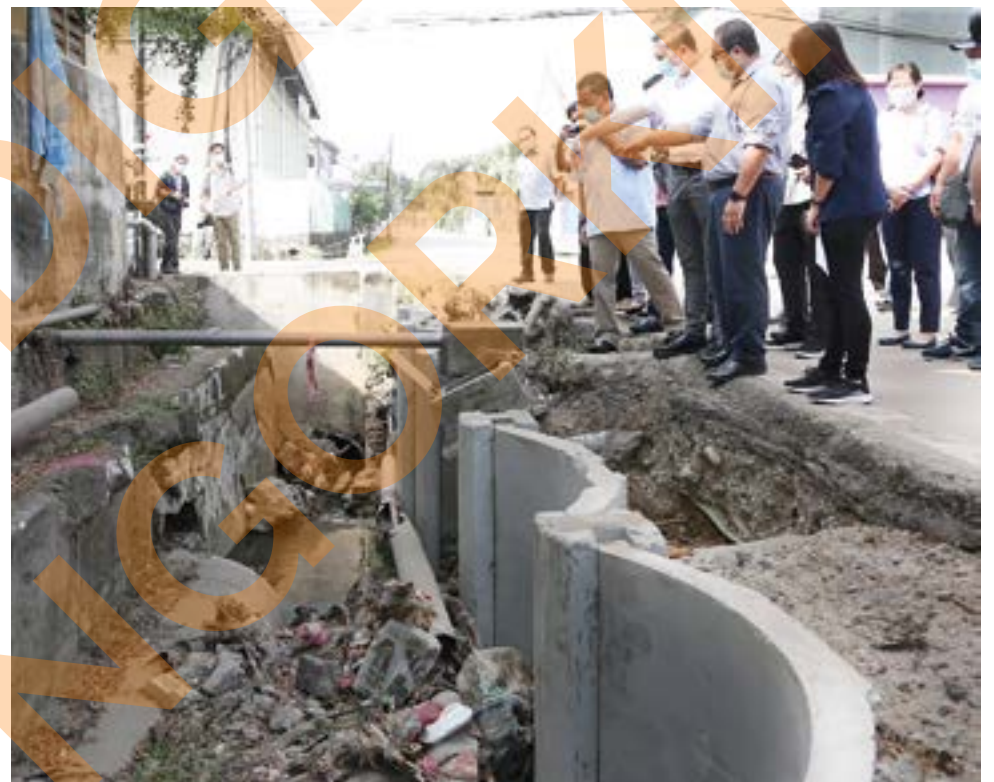
Sze Han meninjau tapak projek menaik taraf parit di Jalan Industri 9 Kampung Baru Sungai Buloh, Shah Alam pada 10 Ogos
