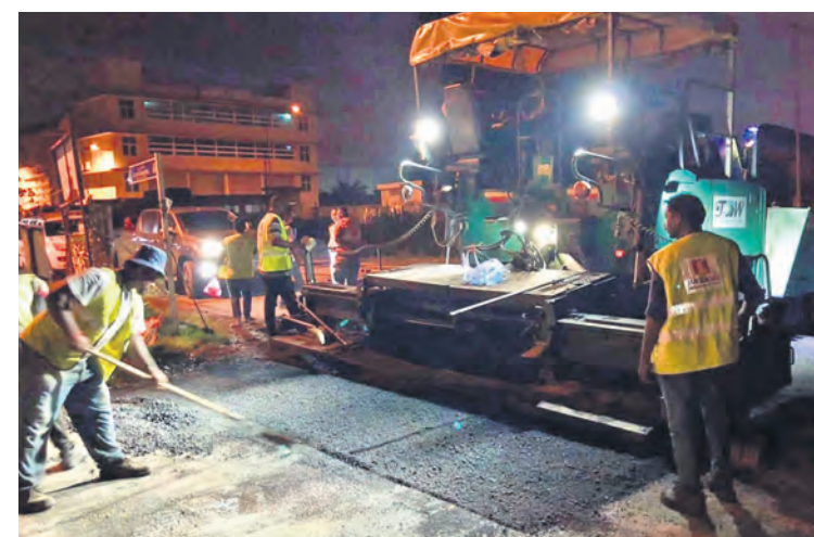
Petugas Infrasel Sdn Bhd menurap laluan di Jalan Telok Gong, Pelabuhan Klang pada 18 Januari. Dana RM50 juta disediakan bagi kerja turapan meliputi 94.9 kilometer di seluruh negeri tahun lalu
