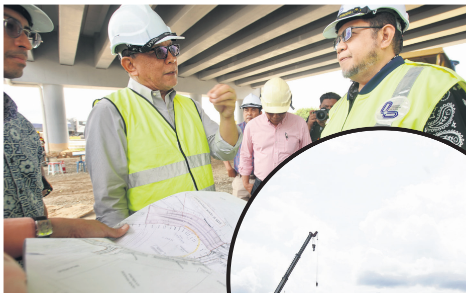
▲雪州行政议员依兹汉(左)巡视太子城高架天桥的施工进展。
