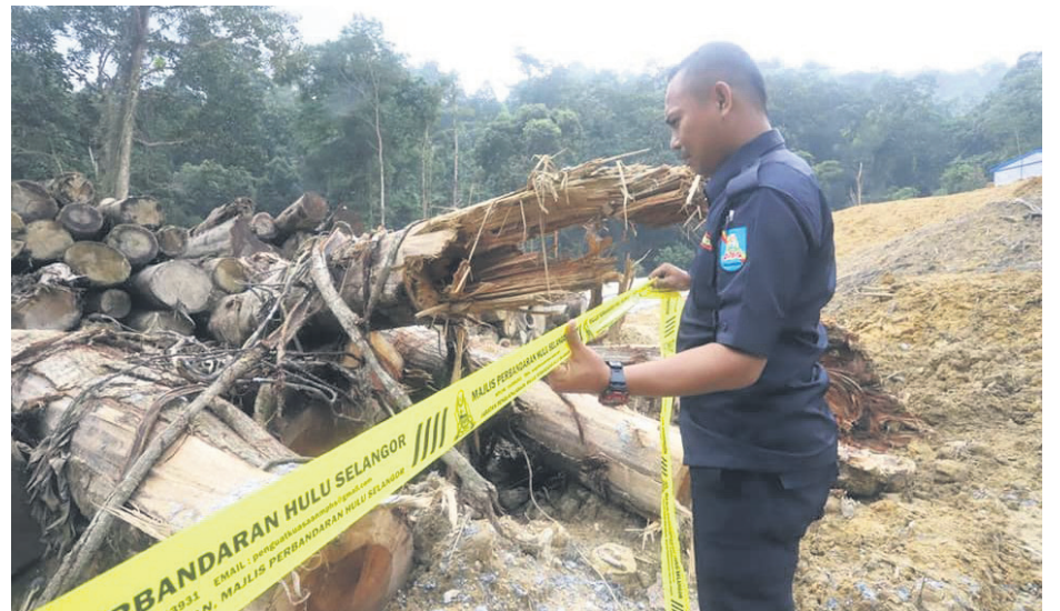
▲执法人员查封违例的施工地点。
