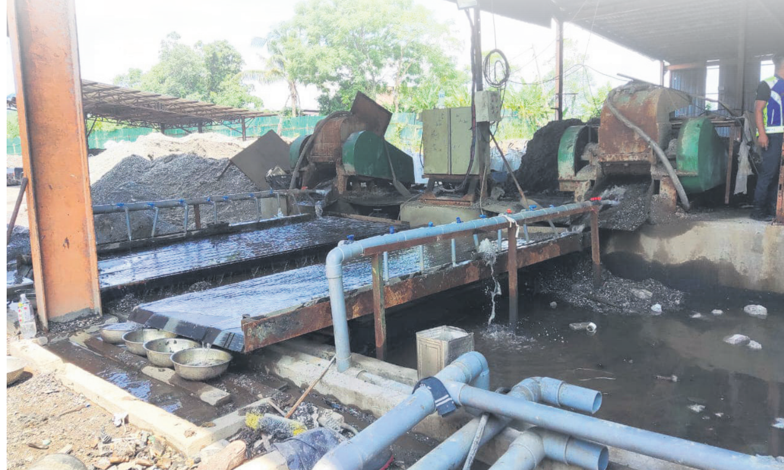
▲塑料再循环厂涉嫌违例排放污水进入河流。
